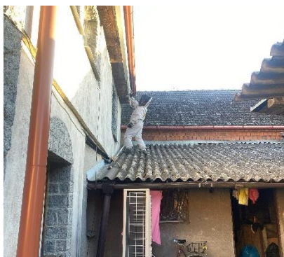
Obrázek 3 Likvidace nebezpečného hmyzu ve střešní krytině.
